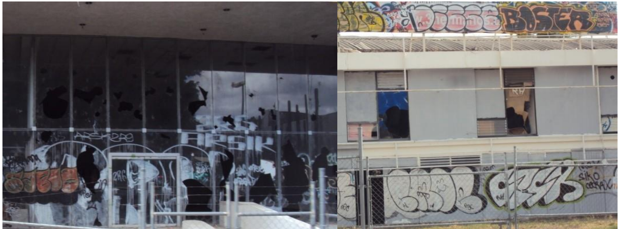
Figura 2. Ejemplos de Edificios en deterioro (ventanas rotas) sobre el Boulevard Adolfo López Mateos en la ciudad de León, Guanajuato. (Fotografías por autores).
