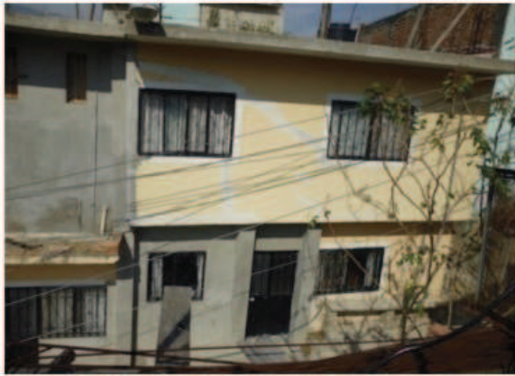
a) Muros de vivienda agrietados
