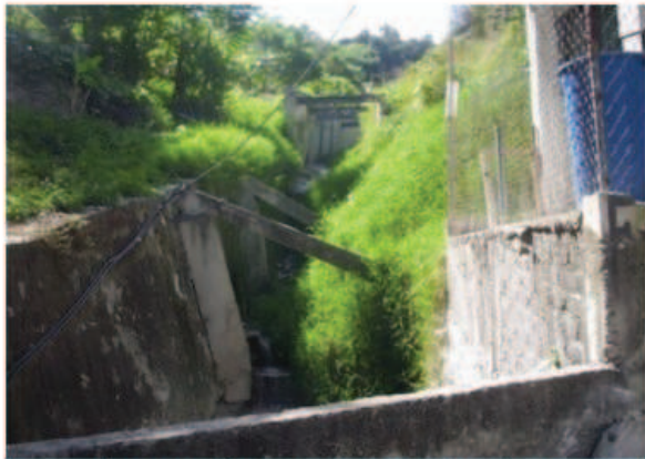
d) Muro de concreto con desplome
