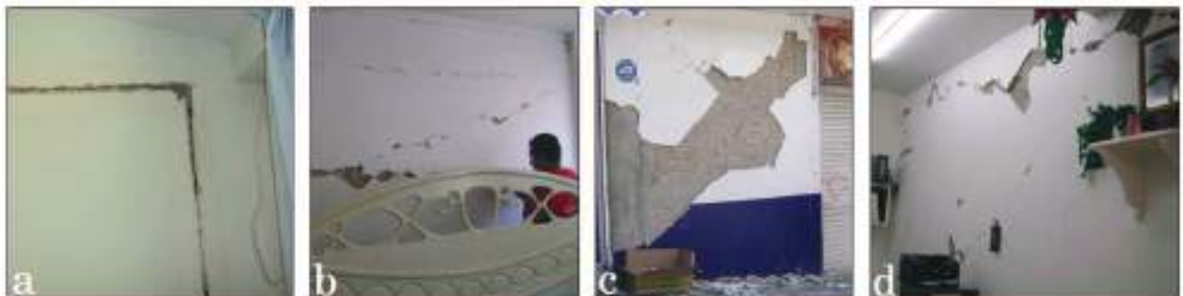
Figura 13. a) Separaciones de muros divisorios de los marcos de concreto, b) fisuras por cortante, c) Daño moderado por tensión diagonal en muros de mampostería y d) por desprendimiento del extremo superior en muros divisorios, en el Centro de Chilpancingo, Gro. Fotografías: SEPC
