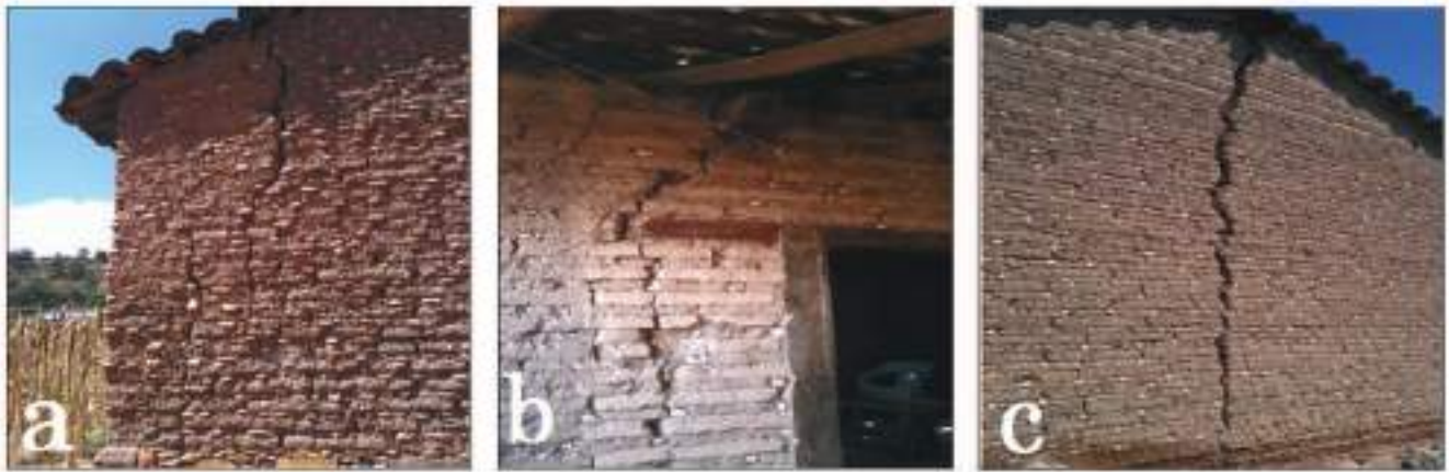
Figura 4. Agrietamientos: a) esquinas de muros, b) esquinas de vanos, y c) zona central de muros. Fotografías: R. Arroyo Matus
