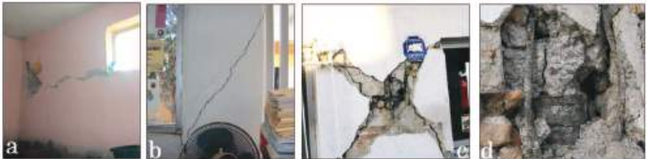
Figura 12. a) y b) Daños por cortante en muros de mampostería en vivienda típica de mampostería, y en columnas cortas. Edificio de la Secretaría de Desarrollo Social Federal en la ciudad de Chilpancingo. Fotografías: Elidio Hernández, c) Mampostería deficientemente confinada y d) con instalaciones sanitarias al interior de los castillos, en Chilpancingo, Gro. Fotografías: José Luis Hernández Rodríguez
