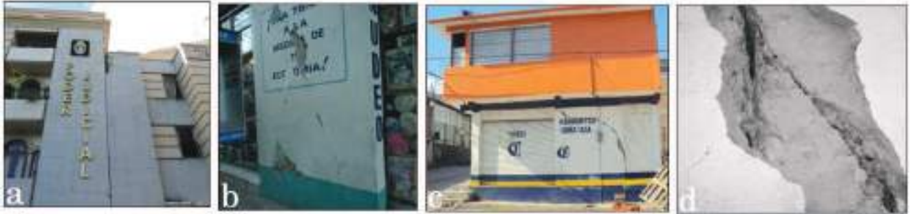
Figura 11. a) Agrietamientos por cortante en planta baja con baja densidad de muro, b) golpeteo entre estructuras colindantes con separación inadecuada en Chilpancingo. Fotografías: Elidio Hernández, c) y d) daños por cortante y torsión en vivienda en esquina con baja densidad de muros en planta baja en Chilpancingo, Gro. Fotografías: SEPC
