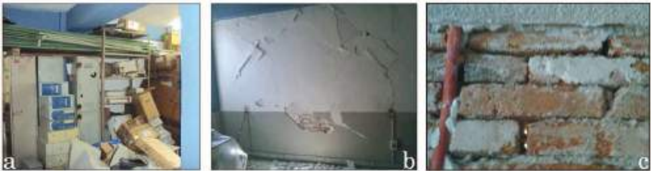
Figura 14. a) Acumulación excesiva de material y archivos en entresijos, b) daño en muro de mampostería, y c) junta inadecuada entre piezas de mampostería. Edificio Telecomm, Chilpancingo. Fotografías: Tizoc Calleja
