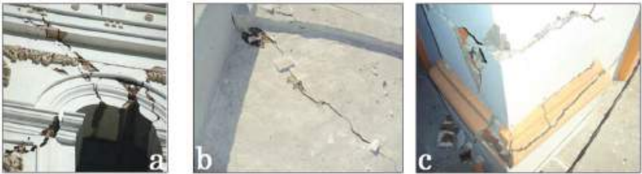
Figura 9. Templo de la Asunción a) Detalles de daño en los recubrimientos de la torre norte. Fotografía: P. Catalán Quiroz, b) en la cubierta abovedada. Fotografía: R. Arroyo Matus y c) Templo de San Antonio con daño por flexión en la base de las columnas de los arcos. Fotografía: SEPC
