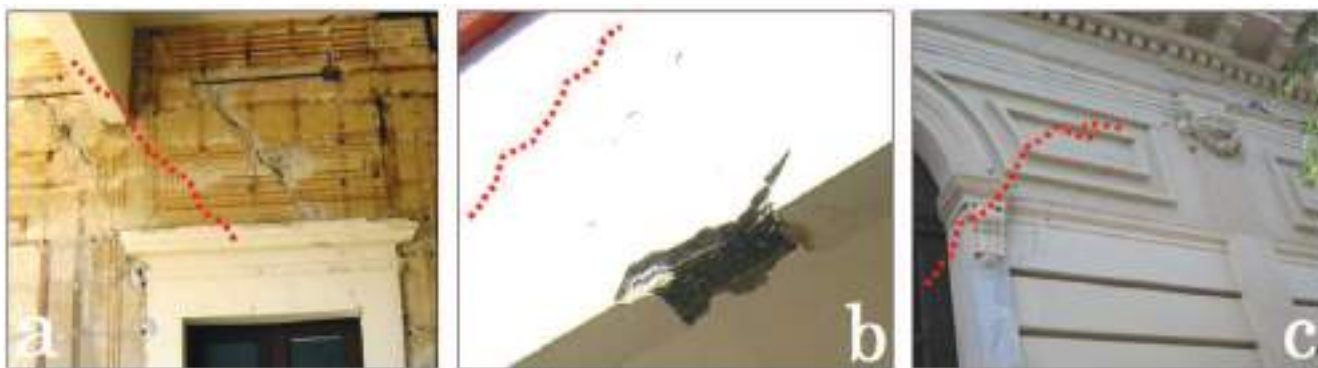
Figura 6. Daños en el Museo Regional de Guerrero: a) Agrietamiento severo por cortante en dinteles y muros de mampostería. Esquina noreste, muro interior. b) Agrietamiento severo por cortante, con pérdida de recubrimiento, en traveses del corredor noreste, y c) Agrietamiento severo de cortante en la fachada norte, producido por el desacoplamiento de sus alas oriente y norte. Fotografías: R. Arroyo Matus.
